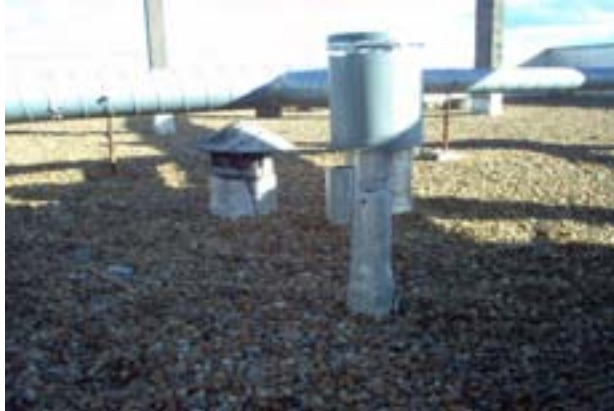
Conduit de fluide (air) ventilation (6 unités)
