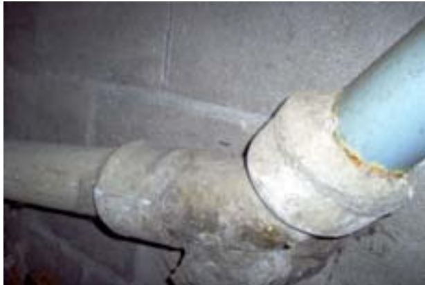
Conduit de fluide (eau) évacuation des eaux usées
