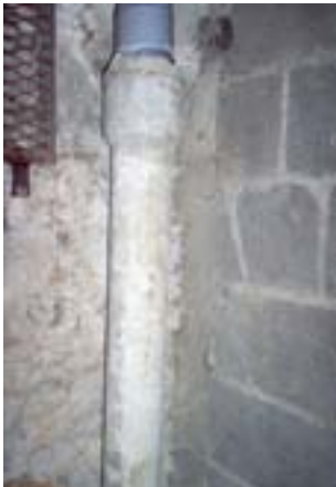
Conduit de fluide (eau) évacuation des eaux usées
